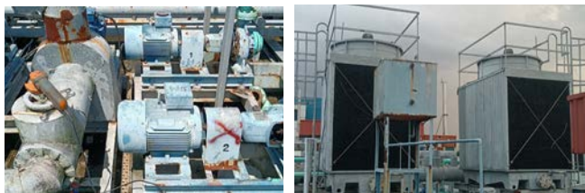
原陈旧水泵及冷却塔
